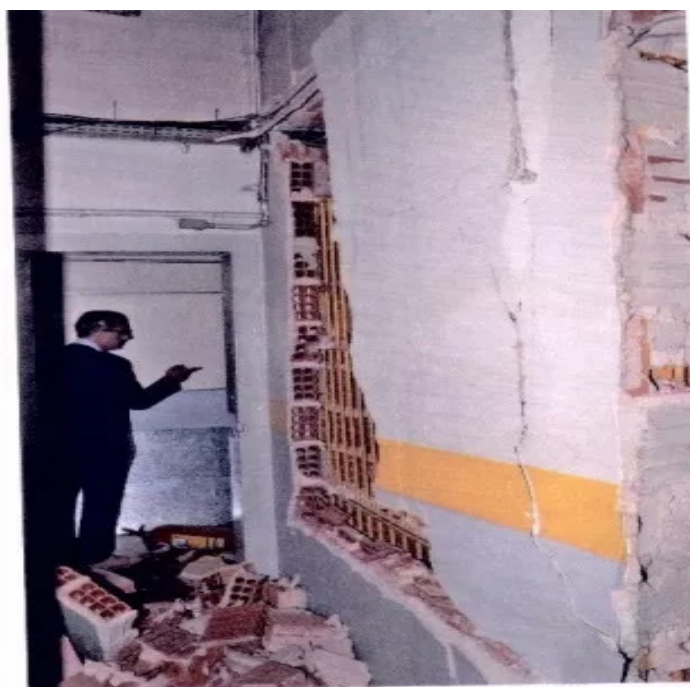
Fotografia 45 - Danos estruturais no interior do prédio
