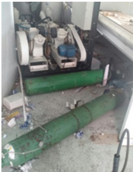
Cilindros de oxigênio após explosão, na UPA de Ceilândia (Foto: Corpo de Bombeiros/ Divulgação)
